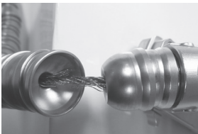
Kuva 7 – Kaapeli, jossa näkyy väsyminen ja rispaantuminen
